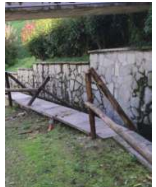
Due fotografie che testimoniano i danneggiamenti alla palizzata che si trova lungo la passeggiata degli Alpini a Candelo
